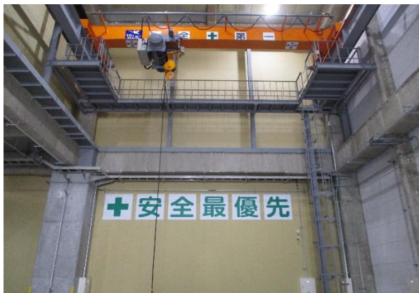
10 トン天井クレーン
